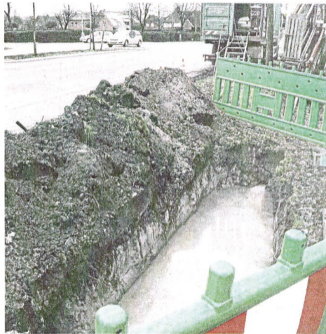
Die Firma Beermann verlegt Kabel für schnelles Internet in Schierloh, Püßelbüren und auf dem Dickenberg. Unser Foto zeigt das Horizontalspülbohrverfahren am Püßelbürener Damm.
